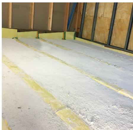
EPS lightbeton 360 läggs mellan bjälkarna, och fylls upp till bjälkarnas överkant. EPS-betongens yta primas med 4180 primer före armeringsnät och ev. värmeslangar monteras.
